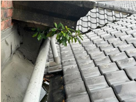
屋頂防水層劣化破損、生長木本植物
