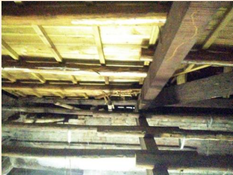
校長室上方屋桁木遭白蟻嚴重蛀蝕斷裂
