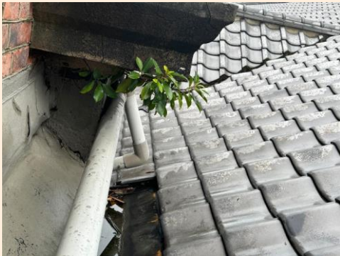
屋頂防水層劣化破損、生長木本植物
